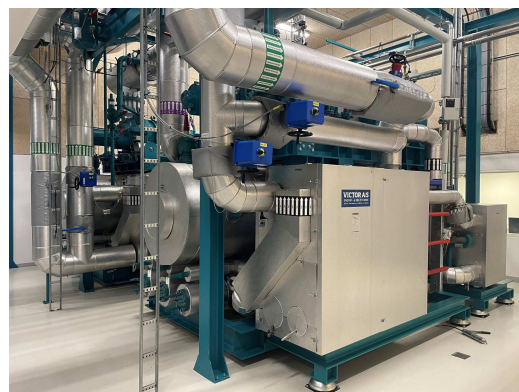
Varmepumpen, der leverer 7 MW varme
